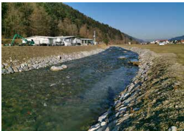
Foto: Mislinja 2021–2022: ob vodotoku zgrajen objekt potrebuje zaščito. Kako je prišlo do gradnje na poplavni ravnici, ni predmet tega članka. Vprašanje je, čemu kamnomet in beton na nasprotni strani? Kaj ščiti, zakaj tam ni obrežja v naravnem stanju? (foto: S. Prijatelj).
