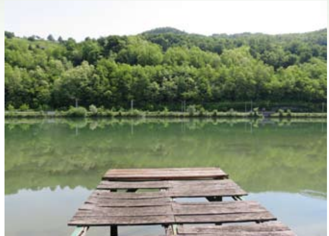
Nekateri pomoli na akumulaciji niso lepi, še manj pa varni.
