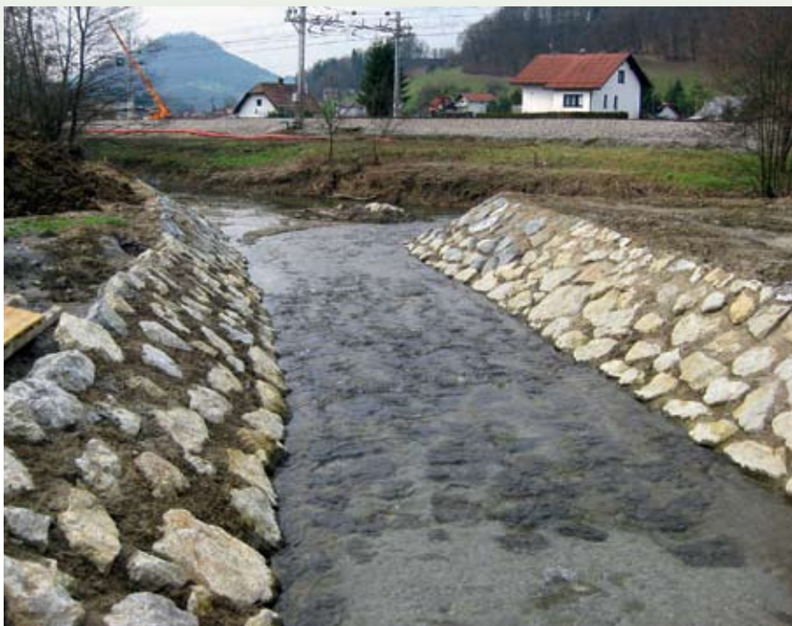
Nekoč dristišče podusti, mreje, klena, ... je po gradbenem posegu še samo kanal za hiter odtok vode in njeno pregrevanje.
