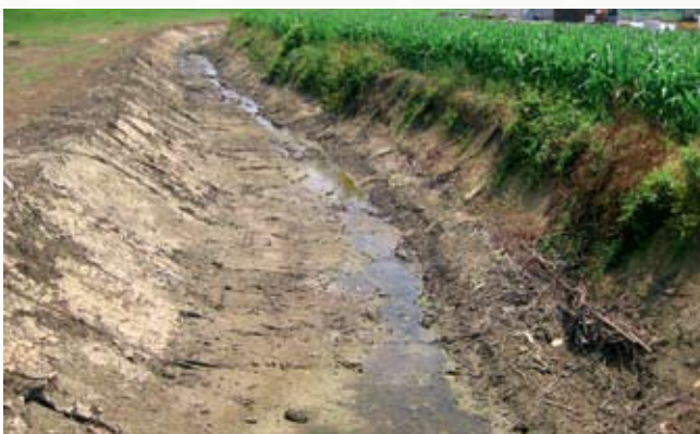
Predimenzioniranje struge, posledica česar je presušitev gojitvenega potoka.
