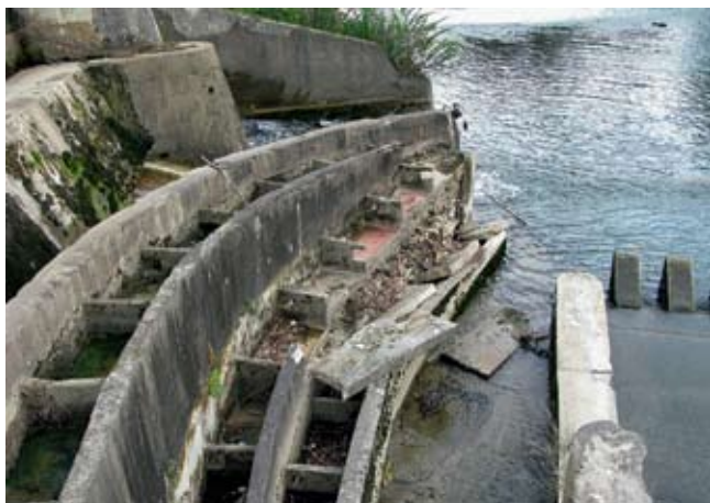
Porušena ribja steza na Fužinah
