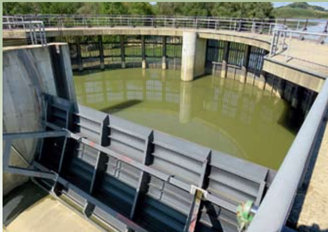
Nov iztočni – prelivni objekt z hidromehansko opremo omogoča daljinsko upravljanje pregrade.
