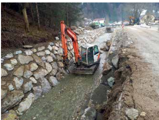
Neprimerna, monotona, poravnana utrditev brežine na potoku Volovljek (foto: Arhiv ZZRS).
