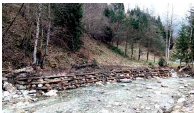
Primer primerne utrditve brežin na Savinji z leseno kašto (foto: arhiv ZZRS).
