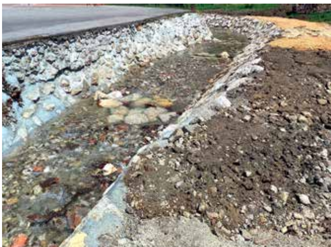
Neprimerna, monotona, poravnana utrditev brežine s kamnom v betonu (foto: Arhiv ZZRS).
